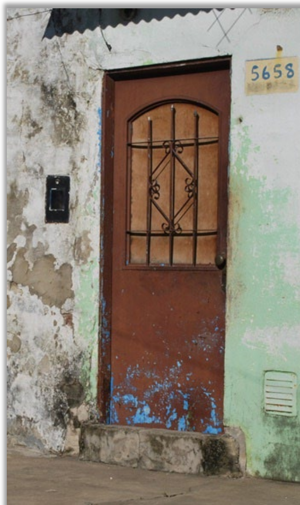
Figura 11: Fotografía actual de la misma puerta.
